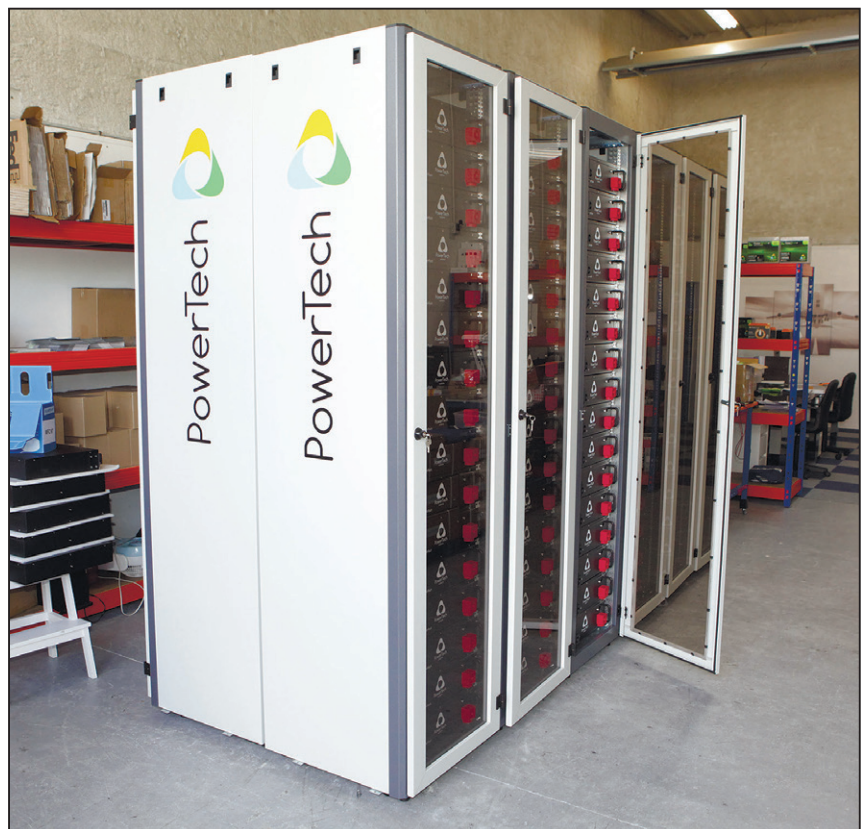
Batterie modulaire de 500kWh pour le projet Allemand de Smart Grid. (© Powertech)
